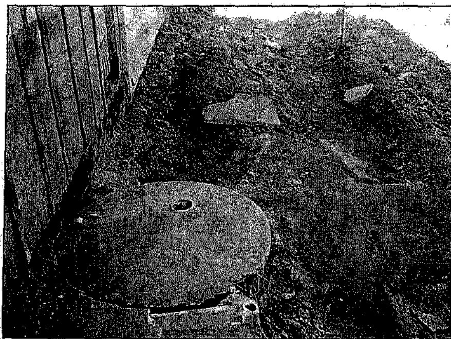
Figura 17 - Fossa mal vedada no município de Buritis Fonte: ECP, Soluções
